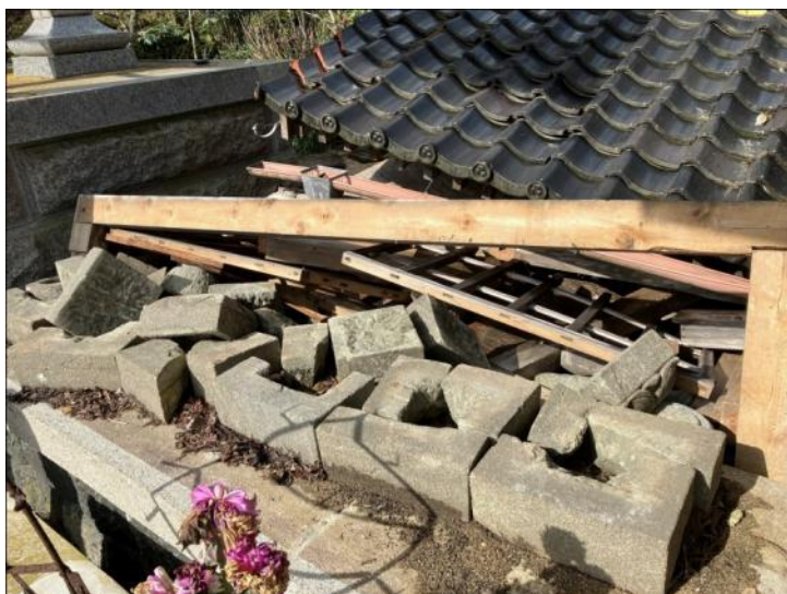
倒壊した地藏堂
