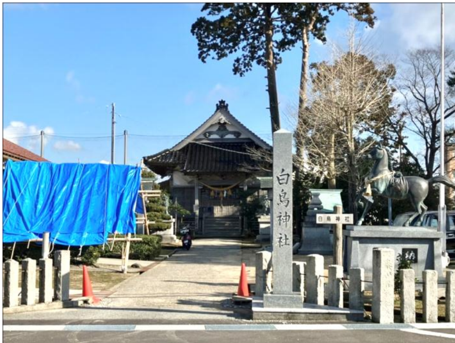
石川県津幡町加賀爪の白鳥神社 2月12日 滝本撮影 社号標柱が少しズレている。4基の灯籠は全て倒壊している。
