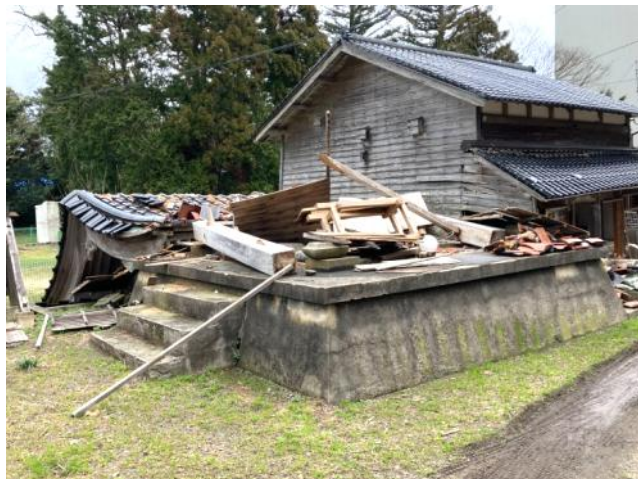
倒壊した鐘楼
