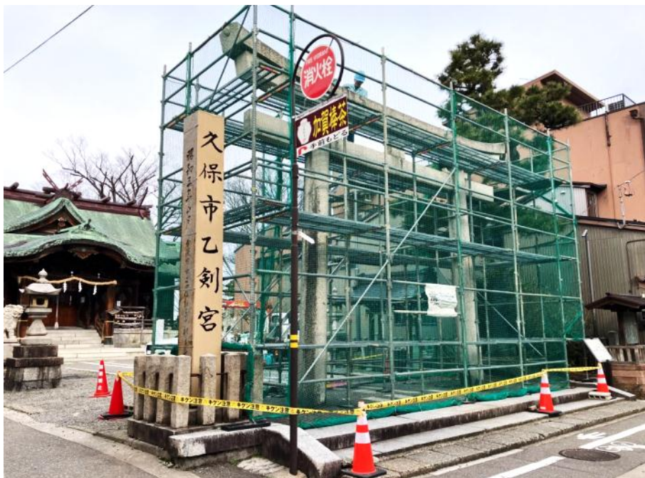
石川県金沢市下新町の久保市乙剣宮 2月14日 滝本撮影 鳥居の笠木の継ぎ目が損傷。補修が行われている。
