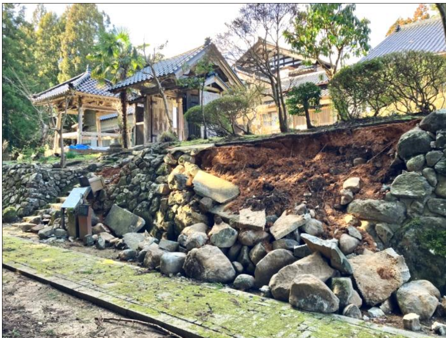
石川県穴水町中居の高野山真言宗明王院 2月17日 滝本撮影 山門前の石垣が崩落している。山門左右の地蔵2体が転倒している。
