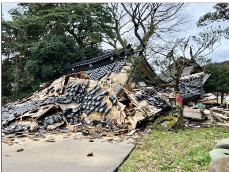
全壊した拝殿
