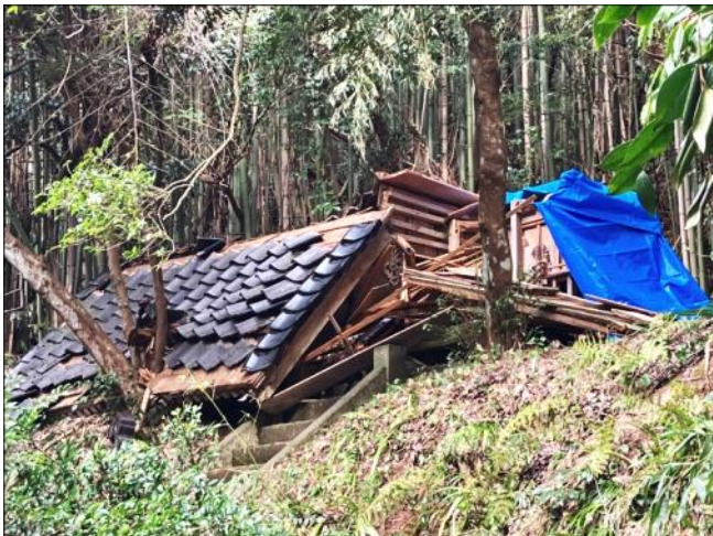
倒壊した本殿
