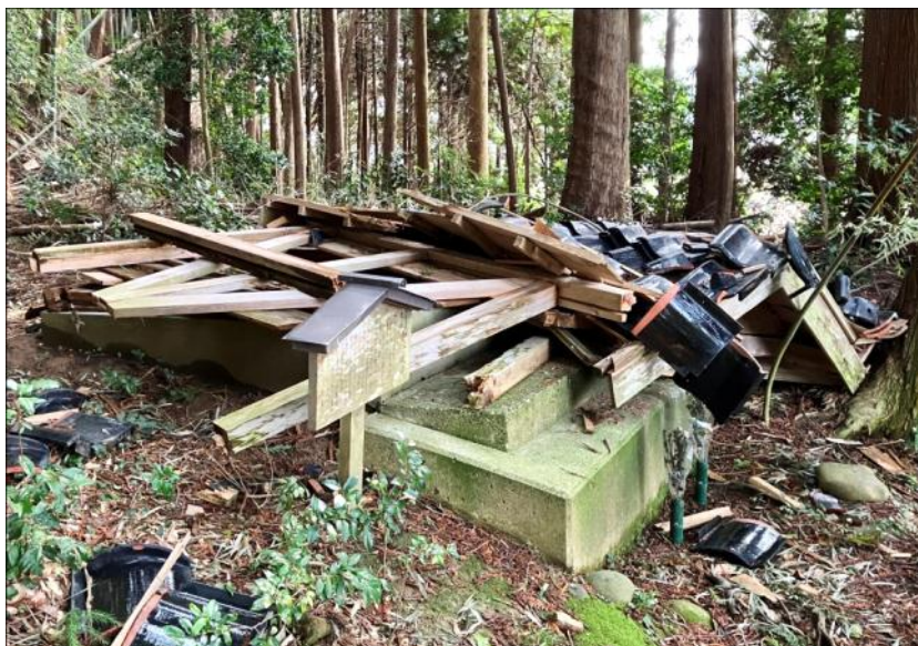
倒壊した覆い堂
