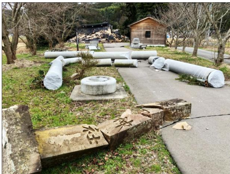
倒壊した社号標柱、鳥居、灯籠など
